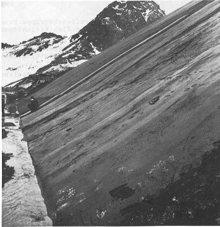
Bild 7 : Zerstörter Mastixbelag am Oschenikseedamm.
