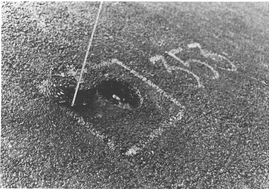
Abb. 10: Loch im Belag und entnommenes Probestück
